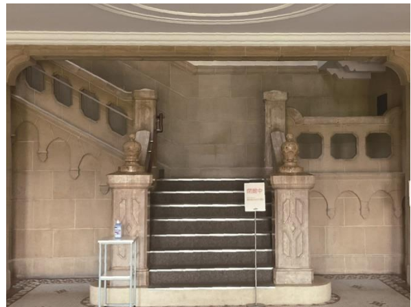
（写真2、アイアンワークが失われた現在の手すり）
