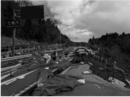
写真1 崩落した道路
