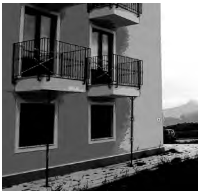
写真 20 使用禁止のベランダ (コレ・プリンチオニ地区)
