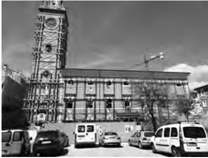
写真 41 ラクイラ中心部の被害建物 (2018年4月)
