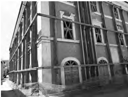
写真 42 中心部の被害建物 (2018年4月)
