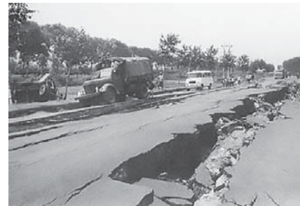
図6 地震による地割れ
