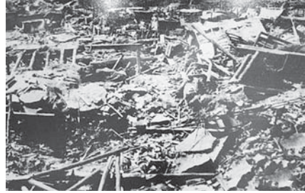
図4 崩壊した建物
