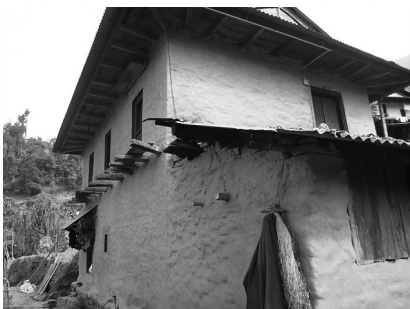
写真6 壁の亀裂を埋めた住宅 (Gudel 村)
