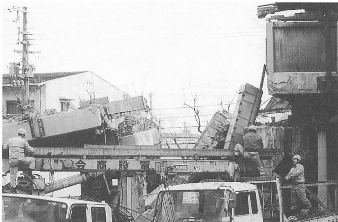
阪急電鉄甲東園駅と門戸厄神駅間に落下した新幹線の高架
